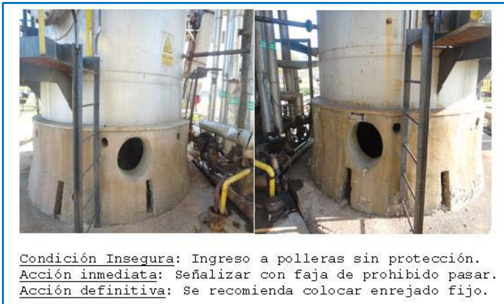
Fig. 3: Ejemplos de identificación de condiciones inseguras previas a la parada
