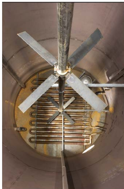
Figura 4- Interior Tanque de Asfalto-Serpentín y agitador
