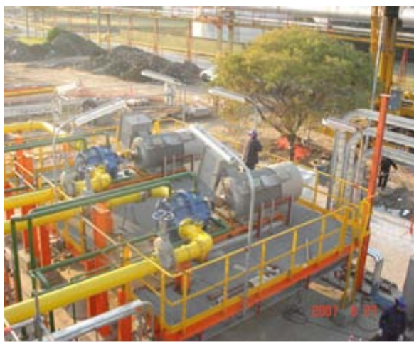
Zona de Compresión I Dos compresores C-100 y C-200
