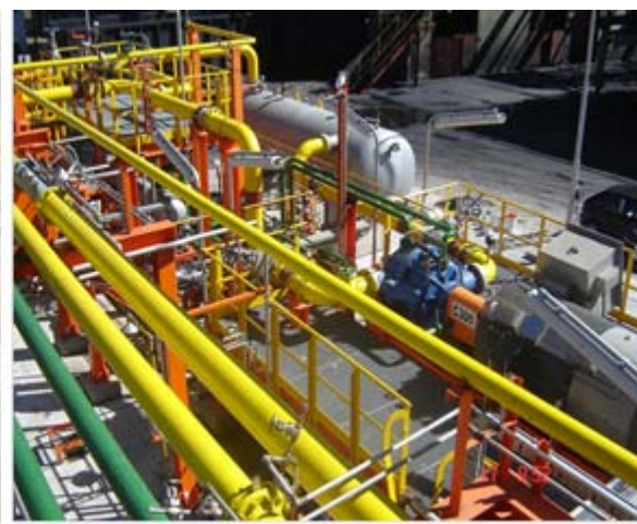
Zona de Compresión II Un compresor C-300
