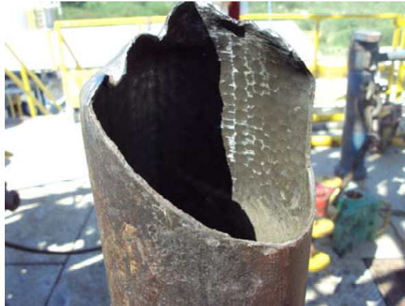
Figura 4: Rotura de tubería por debilitamiento de pared debido a erosión causada por fractura
