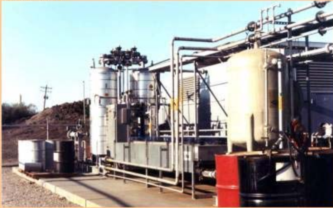
Planta de Cryofuel en las cercanías de Stockton, California
