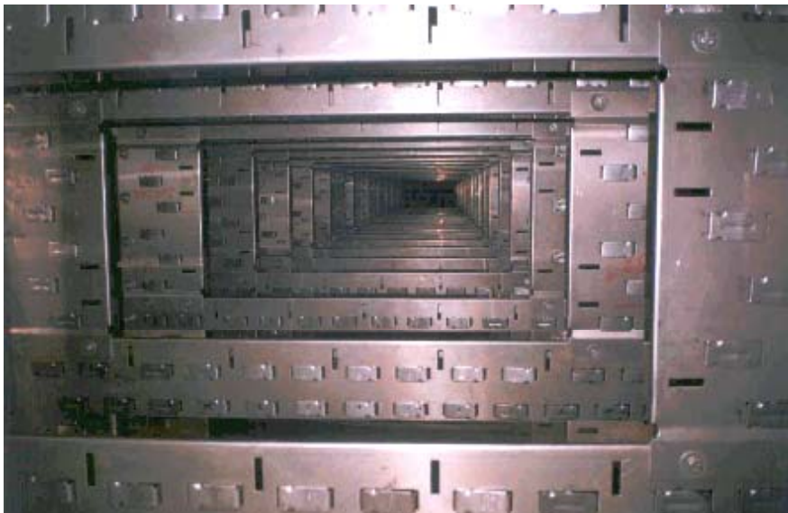
Figura 2. Pasos de hombre en los platos de la torre contactora. Todos los internos son de acero inoxidable.
