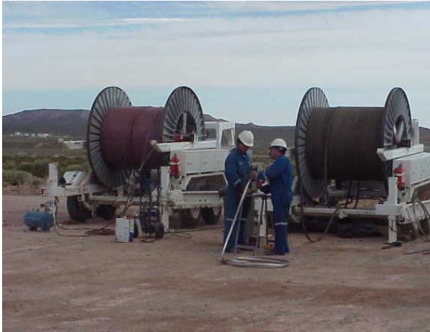
Figura 6: 2 Spoolers para el cable de potencia y línea hidráulica
