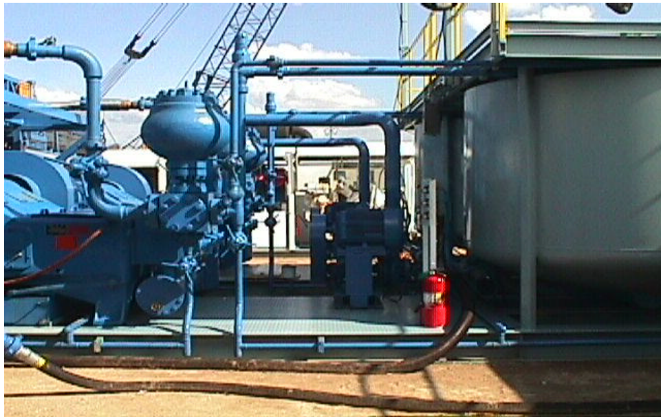
FIG. 6: PATIN PARA EQUIPOS DE CONTROL DE SOLIDOS
