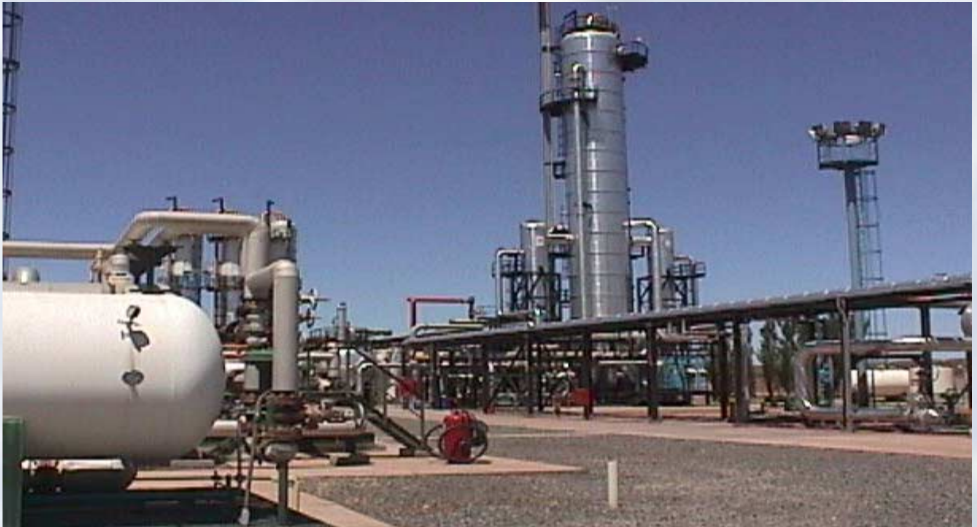
Planta de Dióxido De Carbono
