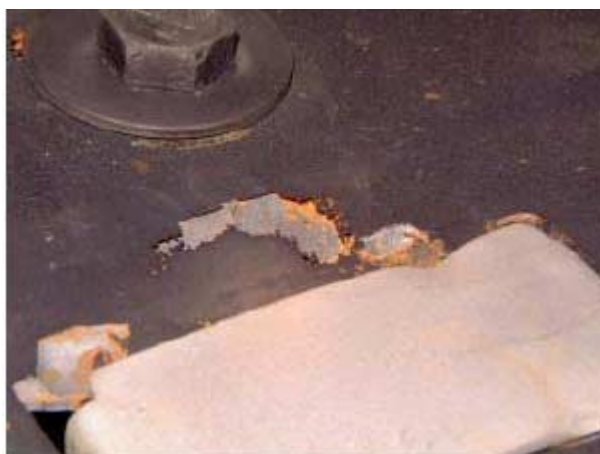
Figura 1: Corrosión por desprendimiento de gas ácido en la zona inferior de la torre contactora. Las picaduras tienen una profundidad de aproximadamente 1 mm.
