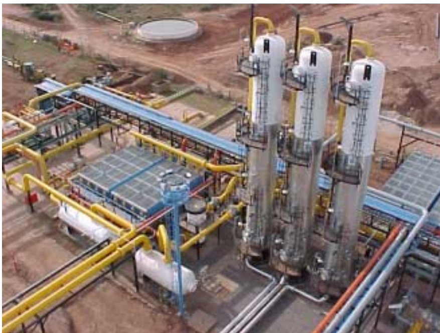
Figura 3: Torres contactoras de la planta de Loma de la Lata. Puede apreciarse la aislación térmica en los dos tercios inferiores de las mismas.
