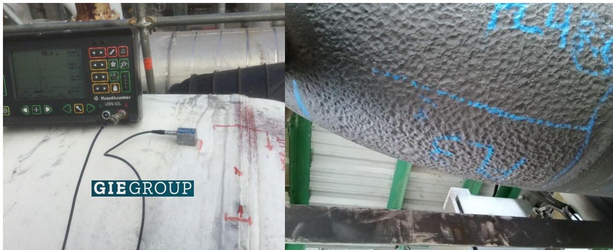
Figura 15 Deteccion de fallas en soldaduras y corrosión
