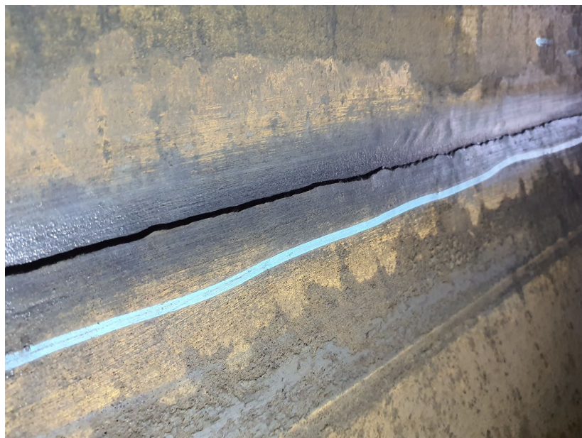
Figura 2 – Indicación en finalización de soldadura longitudinal de envoltente
