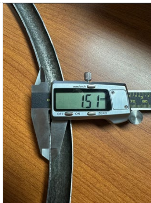
Imagen 12. Espesor de pared del tubo en una de las curvas, en el diámetro interno. El espesor nominal es de 2,11mm.
