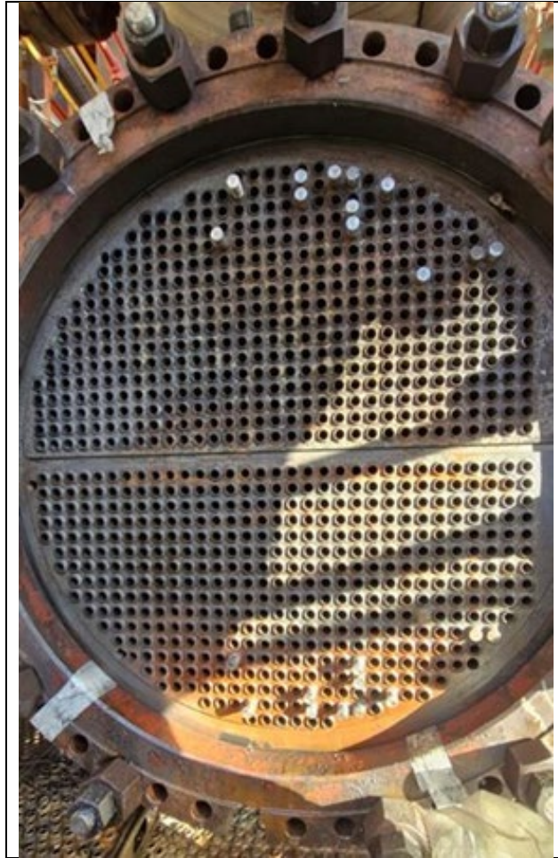
Imagen 14. Placa de tubos con los tapones en los tubos pinchados.
