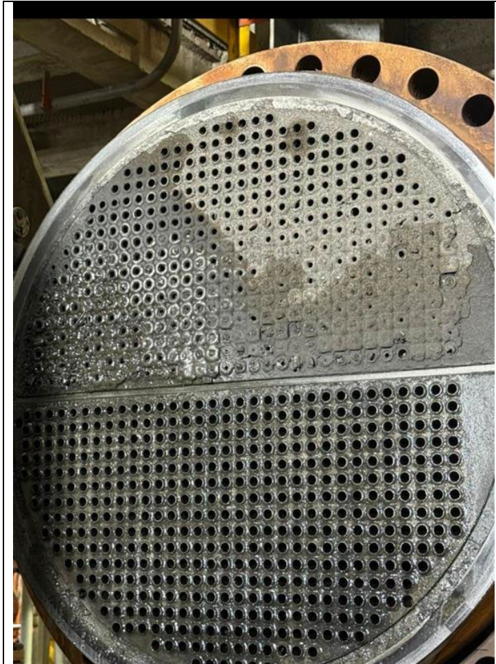
Imagen 9. Placa de tubos de intercambiador 02-B donde se observa muchos depósitos en el interior de los tubos, principalmente en el paso superior.
