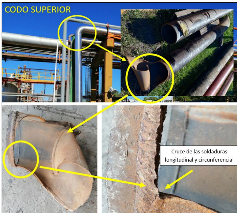
Imagen 1 - Codo superior. Se indica en la imagen inferior derecha el posible origen de la falla.
