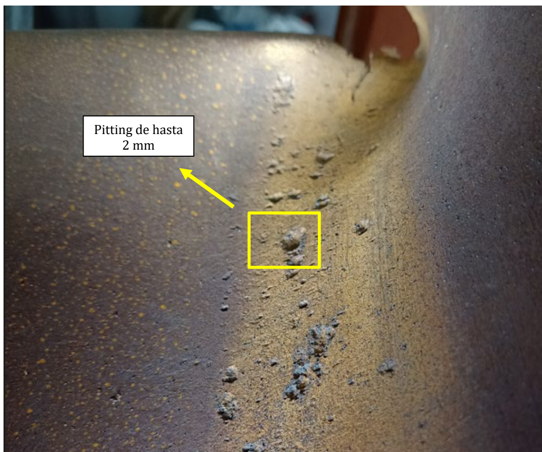
Imagen 20 - Tramo horizontal. Superficie interna de la línea. Se observa corrosión localizada tipo pitting ubicada sobre la franja anaranjada indicando que se trata del lecho.
