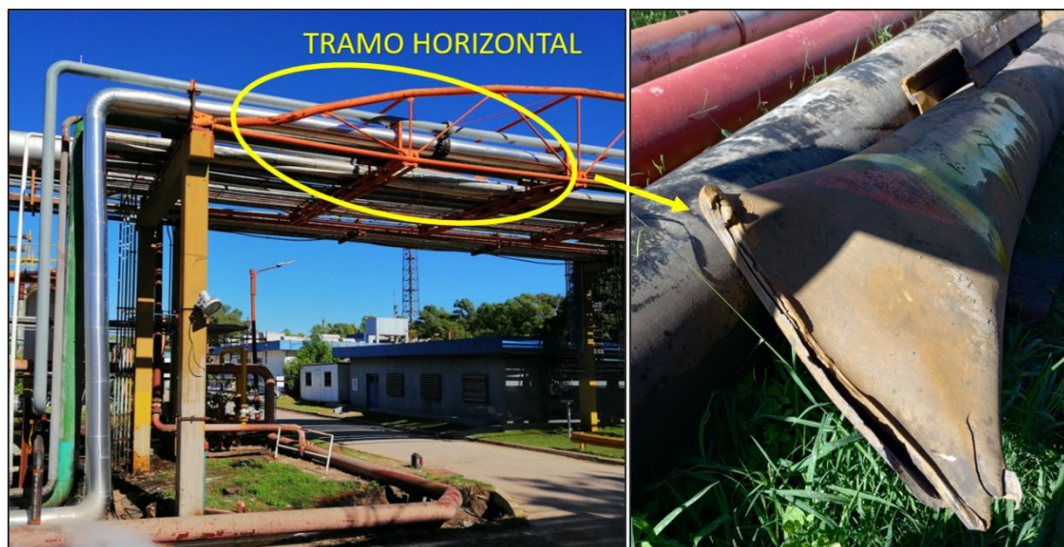
Imagen 19 - Tramo horizontal. Esta parte de la línea quedó en el parral y fue cortado y retirado para la reparación. Se observó que hubo deformación plástica.
