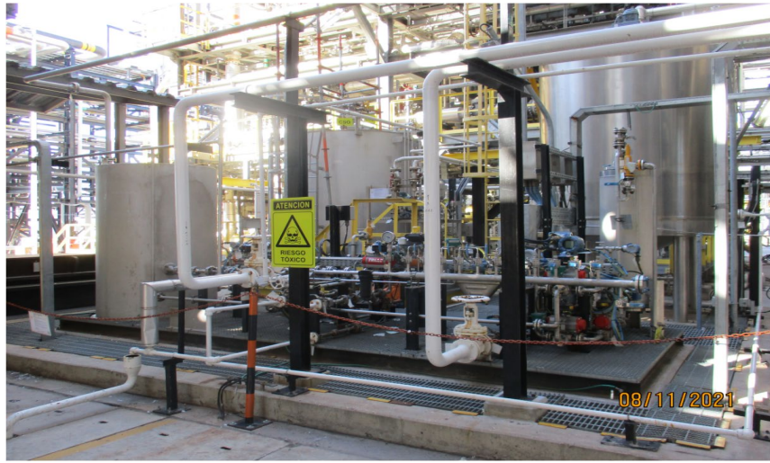
Figura 3: planta de remoción de sales termoestables
