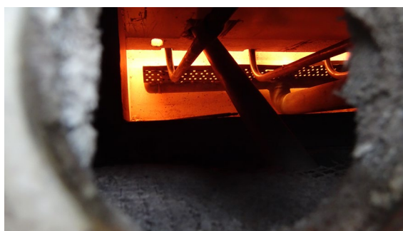
Ilustración 4: Quemador dual. Picos de gas natural y difusor de tail gas
