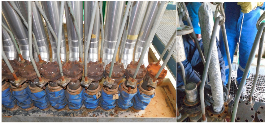
Ilustración 5: tubos de catalizador desde arriba (izq.) | carga de catalizador en tubos (der.)
