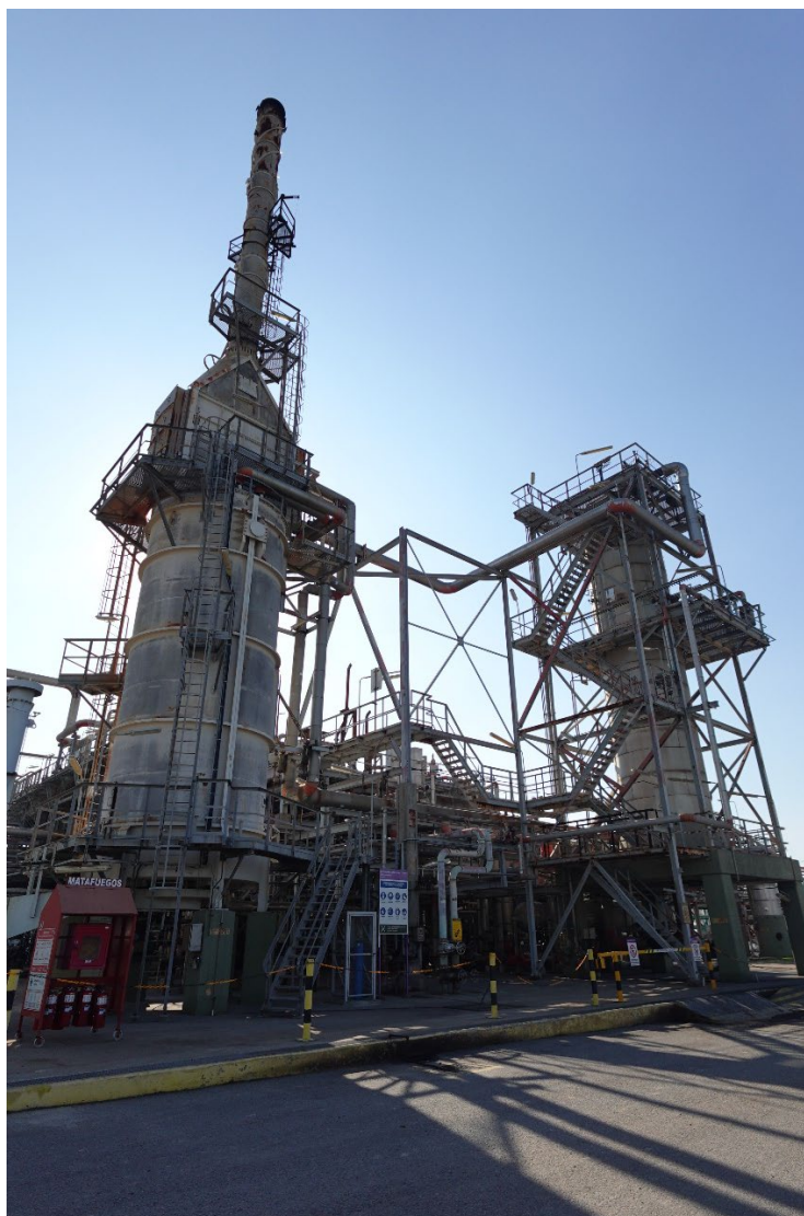
Ilustración 2 Hidrotratador de Gasoil
