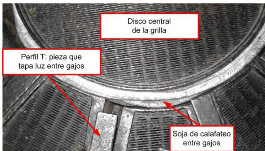
Figura N° 12. Falla de empaquetadura entre disco central y gajos laterales
