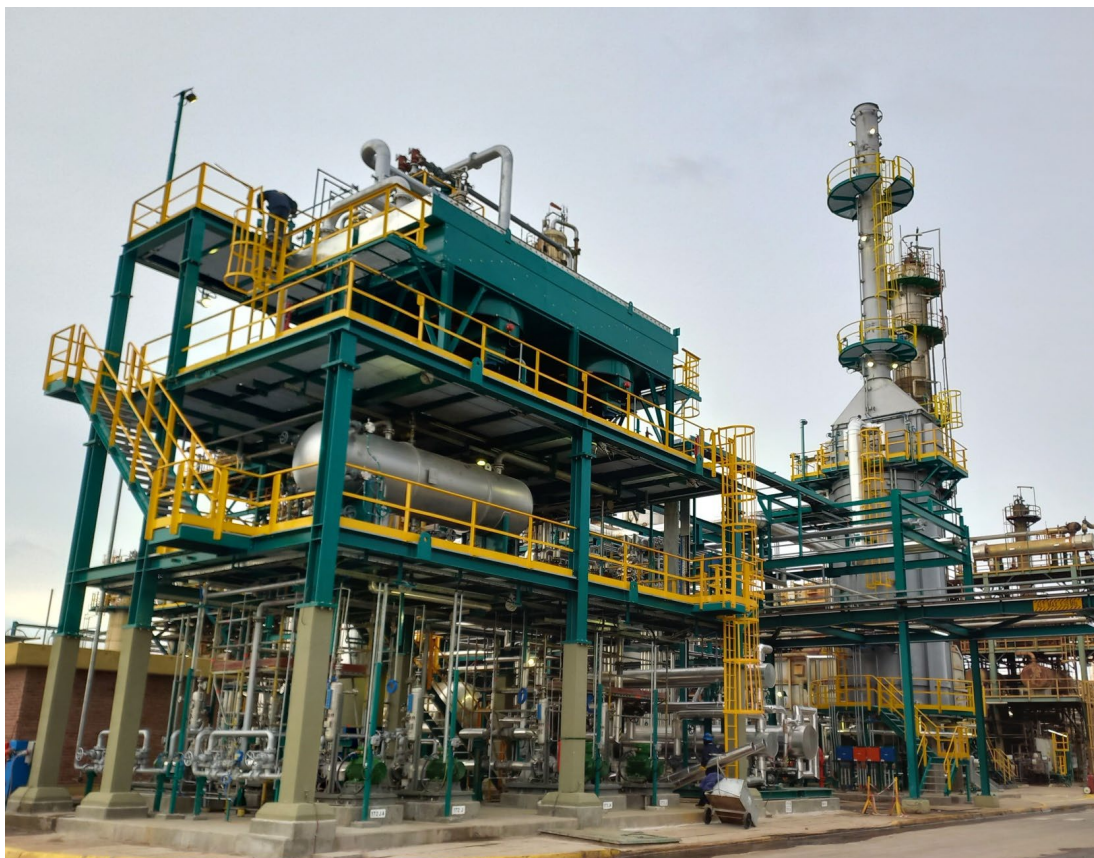
Imagen N°14 Imagen final Skid y Horno
