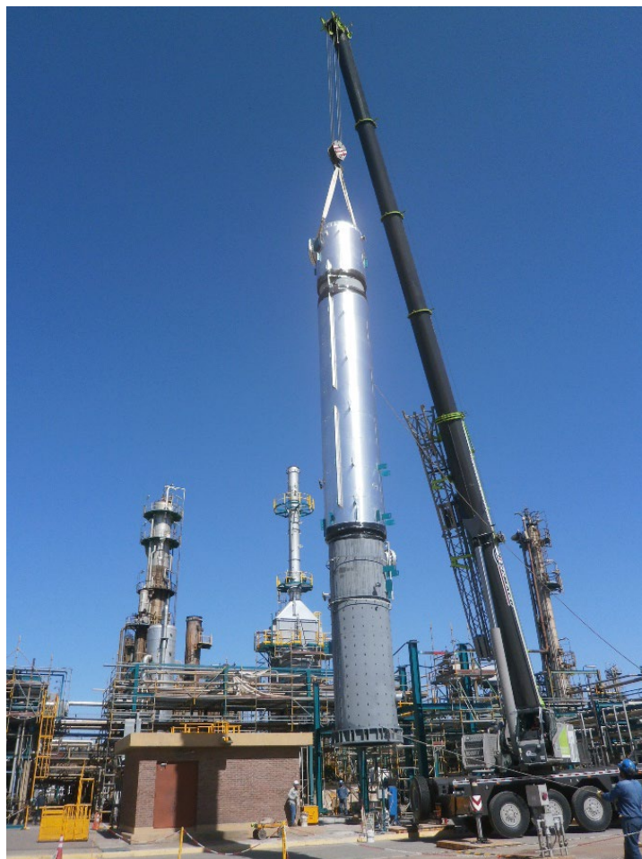
Imagen N°9 instalación Torre Desnftadora
