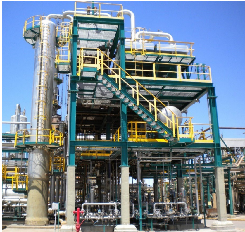
Imagen N°13 Imagen final Torre Desnafiadora y Skid
