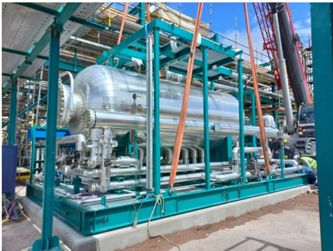
Imagen N°8 instalación Skid Desalador
