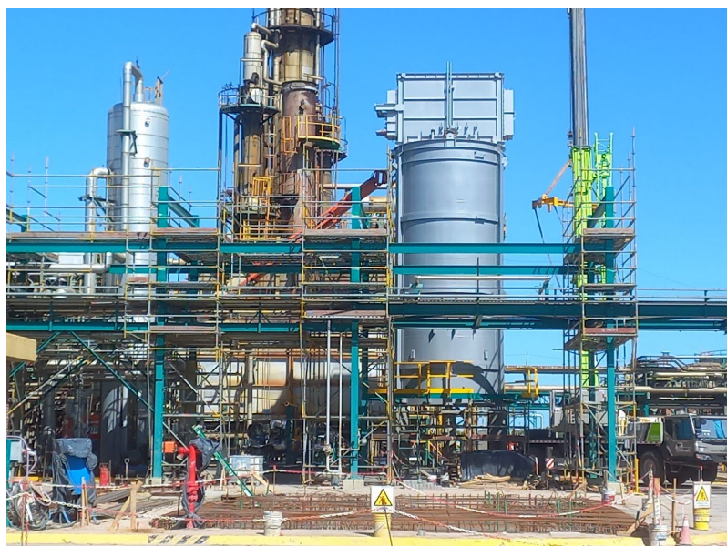
Imagen N°7 Base Skid SK-103
