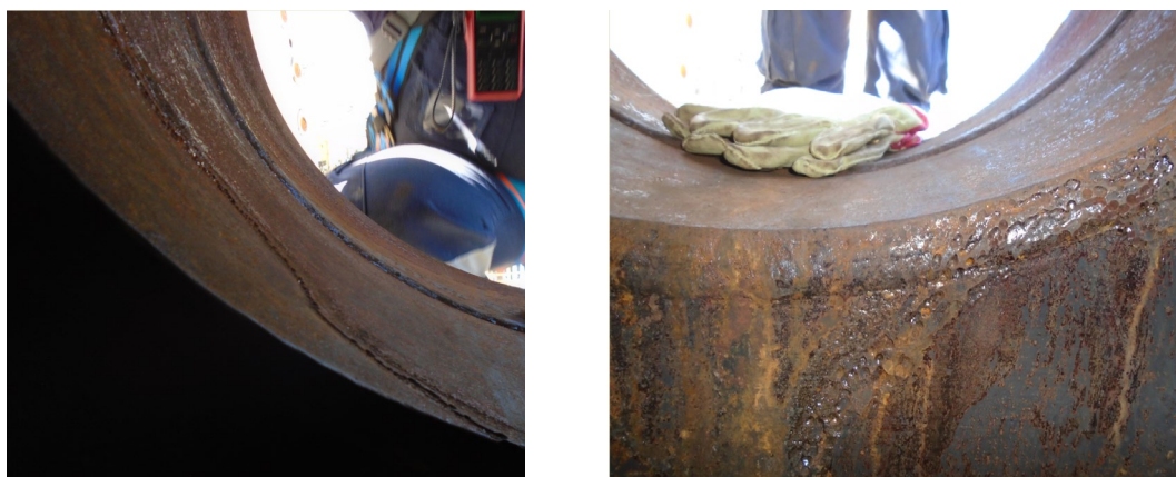
Figura 7: Fotografías del paso de hombre desde el interior además del patrón de pérdida de espesor se ven pits gruesos típicos de la corrosión por CO 2
