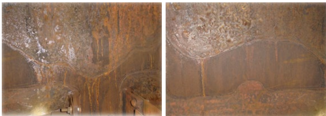
Figura 6: A la izquierda zona de downcomer con pérdida de espesor y a la derecha zona de pérdida de espesor con patrón tipo “ola”
