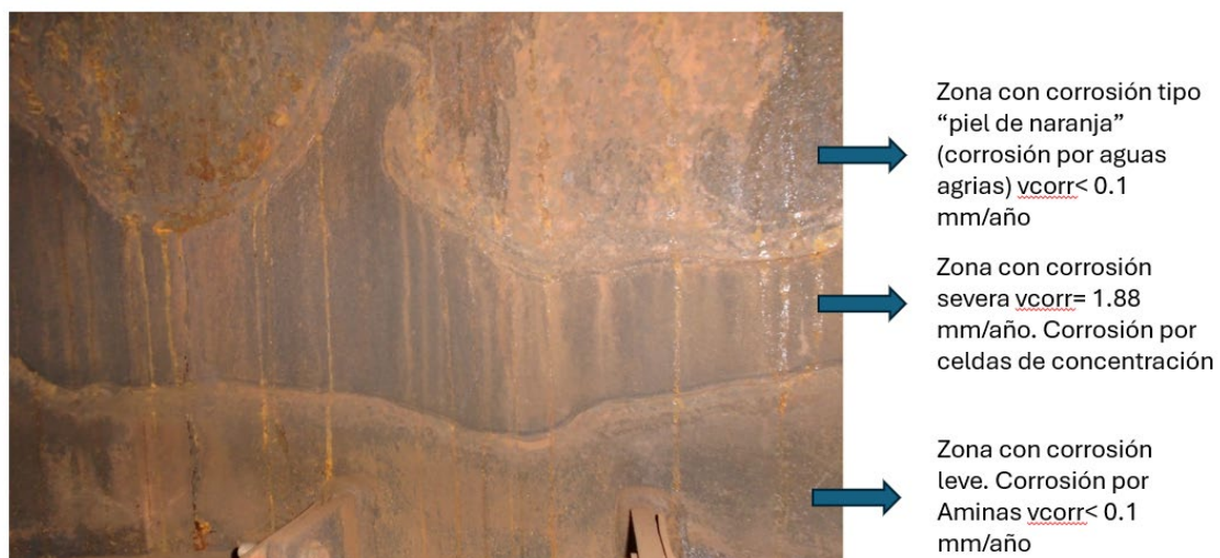
Figura 12: Perfil de corrosión por la presencia de espuma
