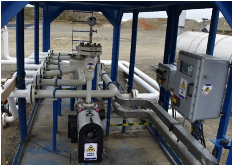
Fig.18– Skid de Medición Multifásica utilizado en el piloto.
