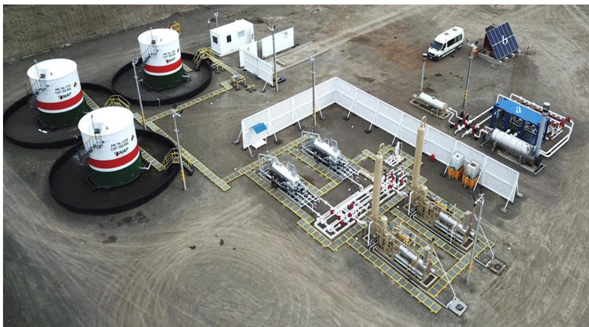
Fig. 15- Prueba Piloto Skid de Medición Multifásica en marcha, en el Pad Estancia Rita ZG-1, se visualiza el skid (a) y el sistema de generación autónomo solar fotovoltaico contigua además a la antena satelital de transmisión de datos (b).
