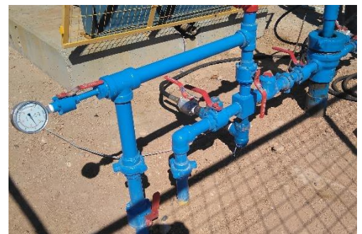
Línea de Descarga
