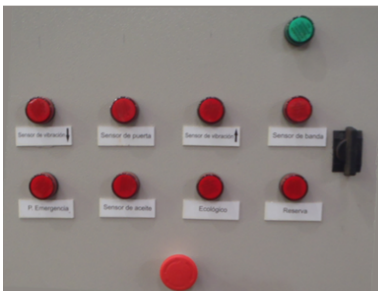
Fig. 5 – Tablero de alarma
