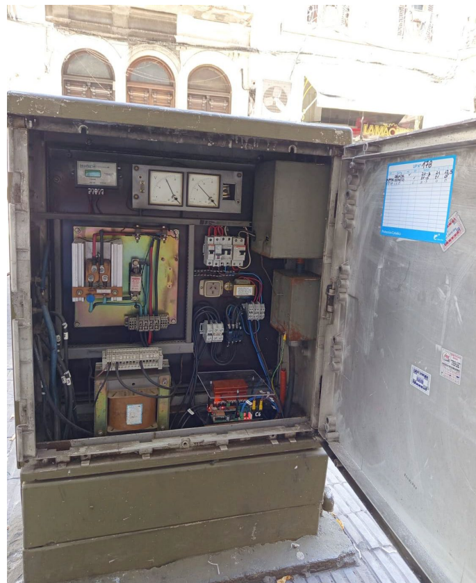
Figura 3-3 Ejemplo de instalación en campo
