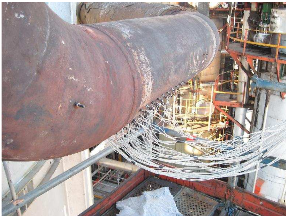
Figura 5 (instalación en Refinería Luján de Cuyo – Cortesía de Fox-Tek y Baker Hughes)
