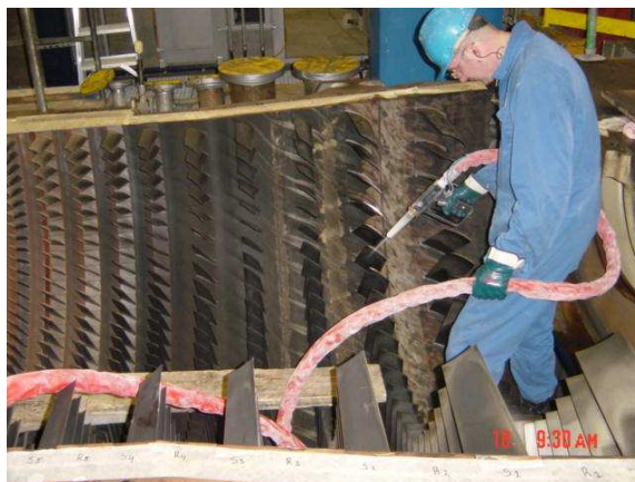
Limpieza Stator Compresor
