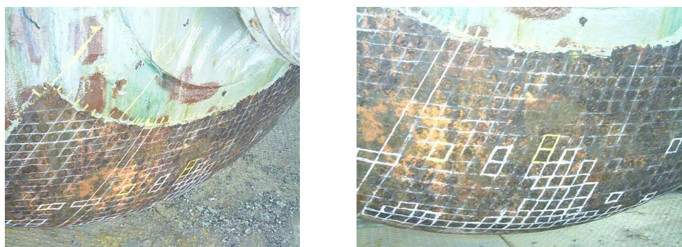
Fig. 4. Zona de bajos espesores, cabezal Oeste Tambor
