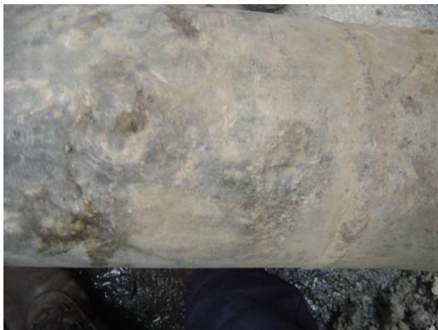
Figura 6: Tipo de falla / corrosión detectado
