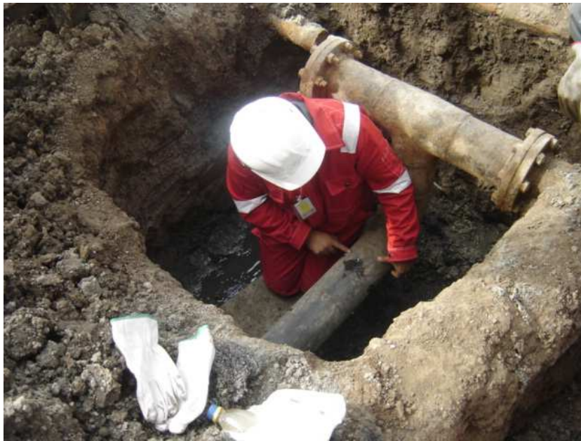
Figura 5: Sector donde se detecto corrosión moderada
