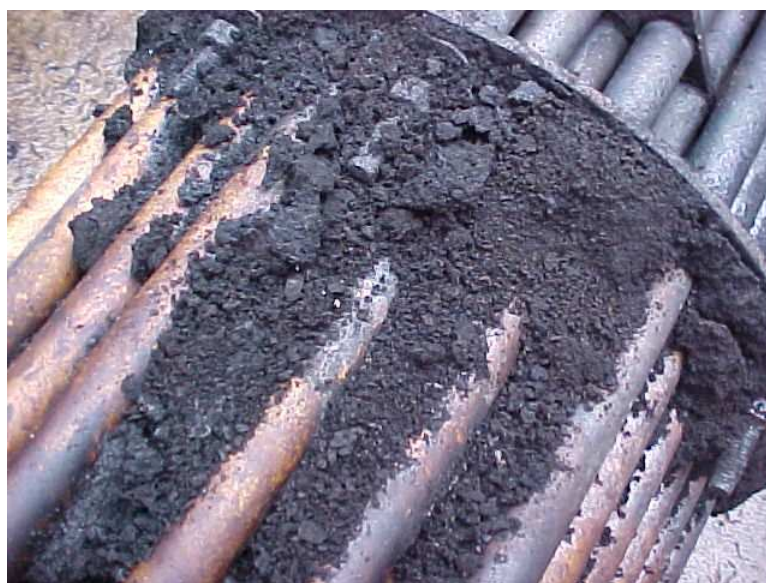
Detalle de lo encontrado en otro enfriador de JP
