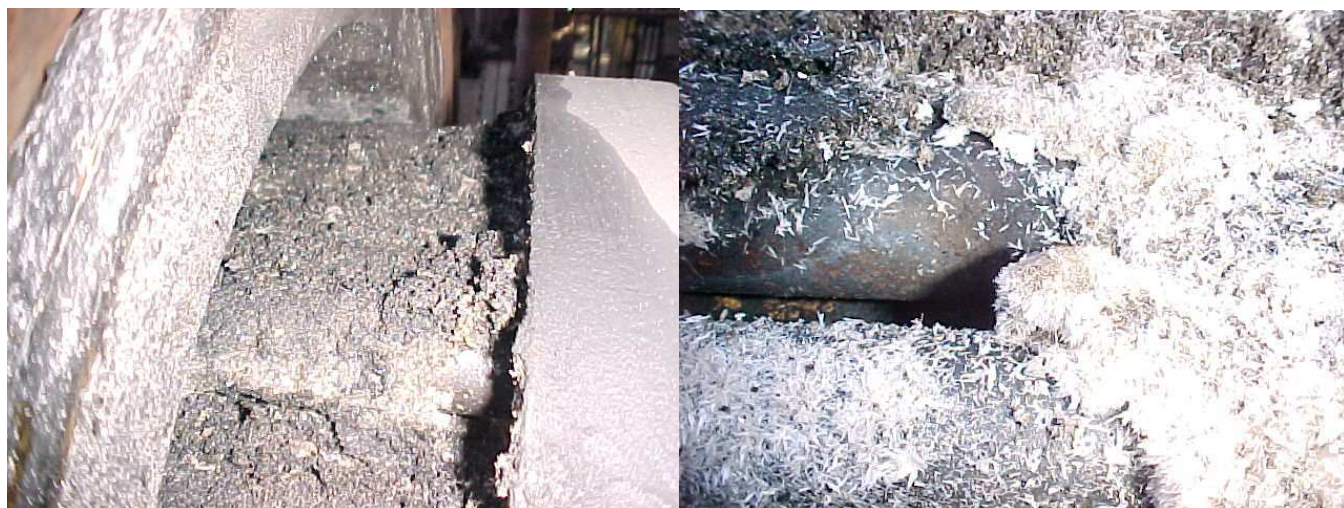
Detalle de lo encontrado en el enfriador E-2 en Octubre de 2007
