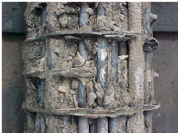
E-2, primer enfriador del circuito de JP
