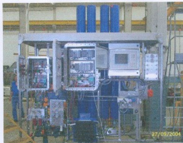
XXXI Skid com partes mecânicas e de instrumentação
