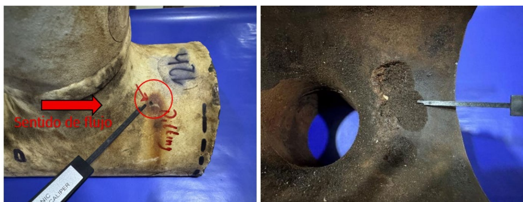
Imagen 6: Identificación de pitting en zona de curvatura accesorio Tee.
