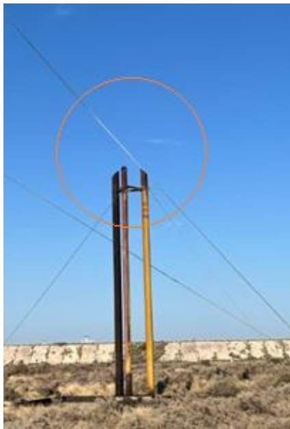
Figura n°7: Galvanizado afectado por exposición térmica
