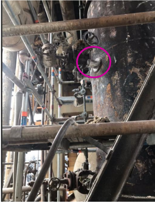
Imagen 1: Vista del equipo desaislado en la zona de falla
