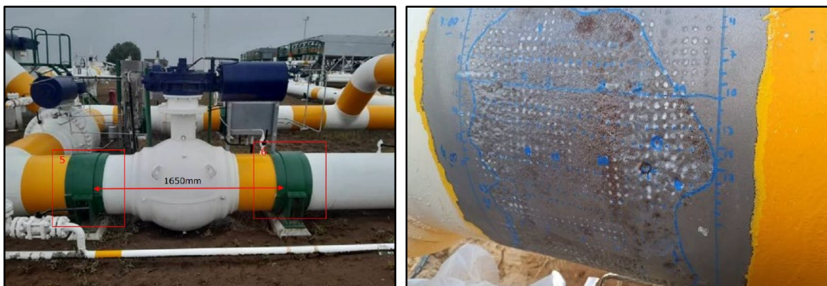
Figuras 14 y 15. Estructura original en estudio y corrosión bajo soporte en estudio.
