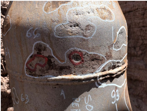
IMAGEN 5 – CORROSIÓN EN CAÑERÍA SOTERRADA
