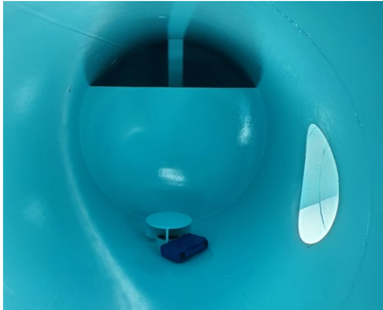
Imagen 13 – recubrimiento epoxi tricapa aplicado internamente
