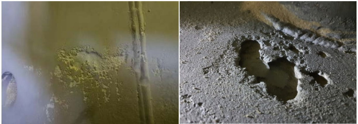
Imagen 9 y 10 –zonas corroídas octubre 2023 – segunda etapa
