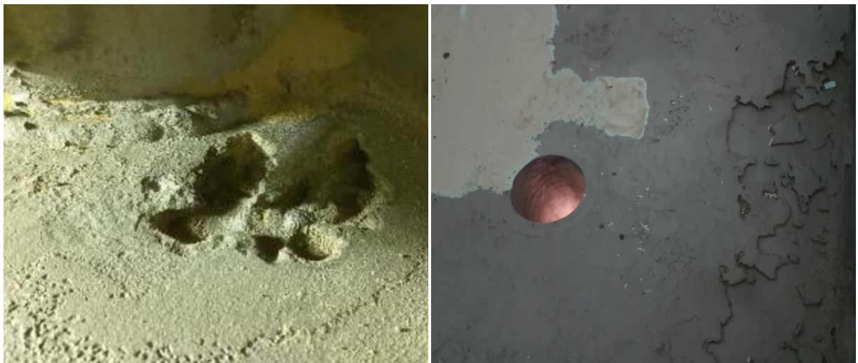
Imagen 11 y 12 –zonas corroídas descarga de agua y lado casquete izquierdo– segunda etapa
