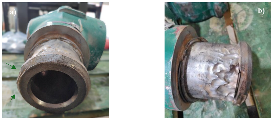
Figura 3. Válvula Check a) Lado externo b) Daños en cuerpo de conector
