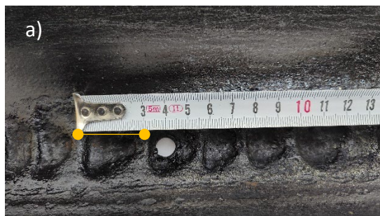
Figura 5. a) zonas socavadas que forman depresiones, cráteres y/o valles, que miden desde 1 a 3 cm de diámetro.
