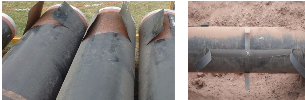
Fig.1 – Falta de adherencia en cañerías en estiba y en operación
