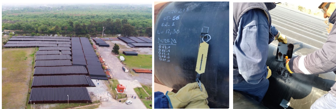
Fig.2 – Estudio destructivo de adherencia en cañerías estibadas.
