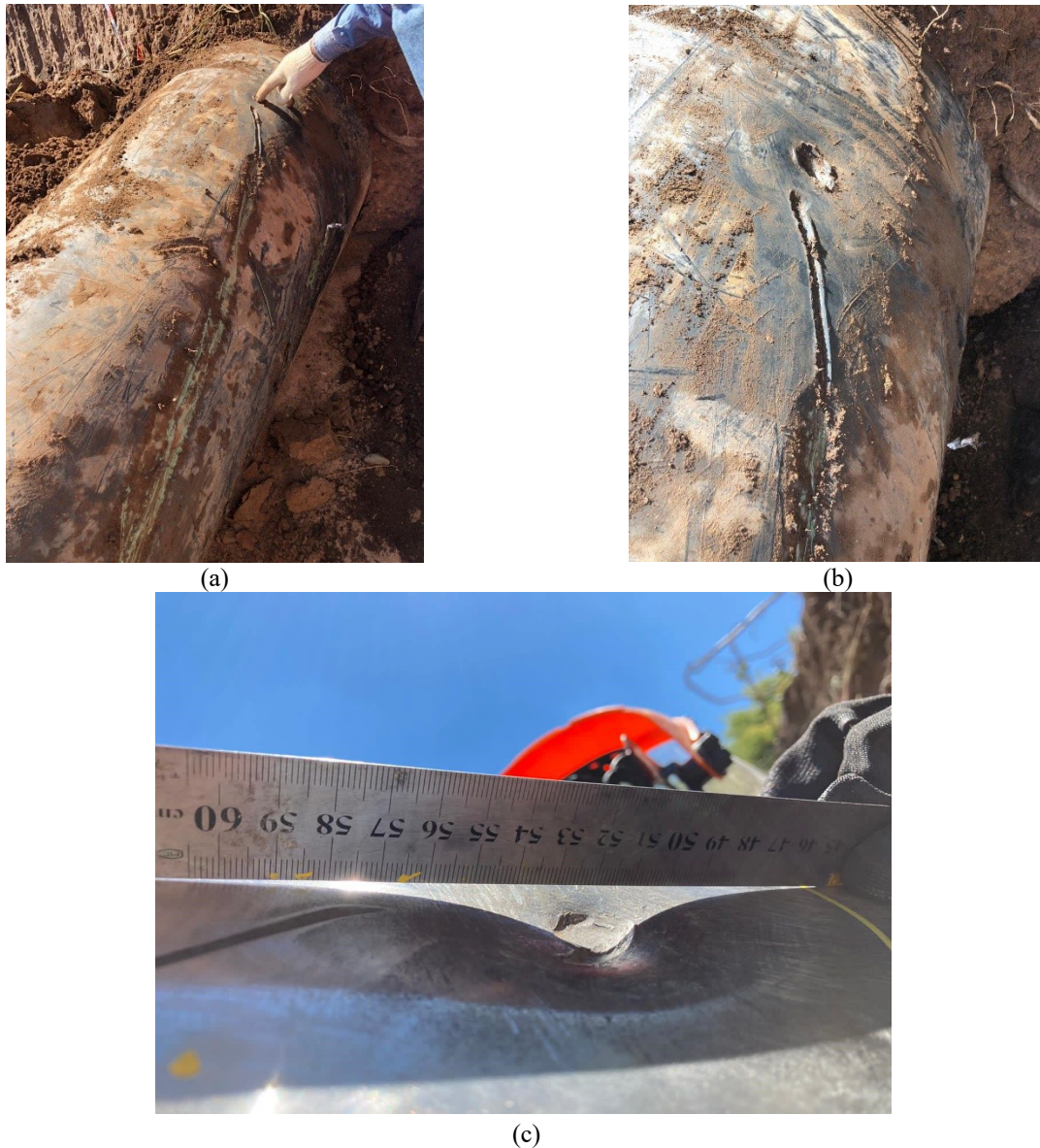
Figura 2: (a) y (b) Daños de pérdida de material encontrados en la cañería, (c) abolladura con arrastre de material con una profundidad aproximada del 1% del diámetro
