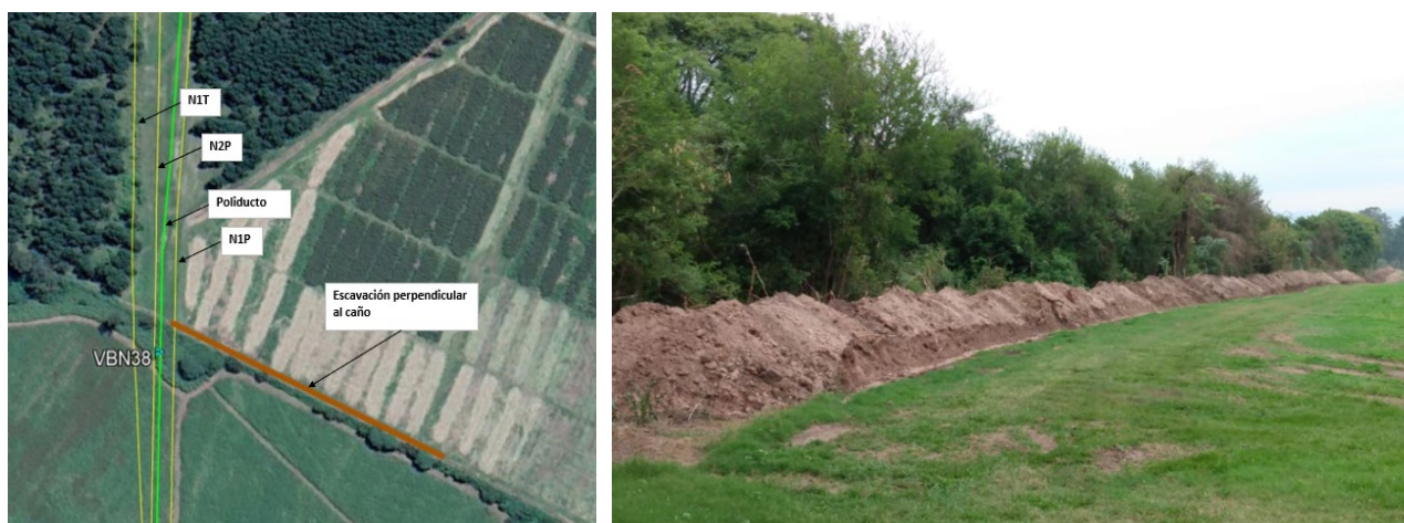
Figura 1: Ubicación del incidente e imagen de la excavación encontrada en el inmueble
