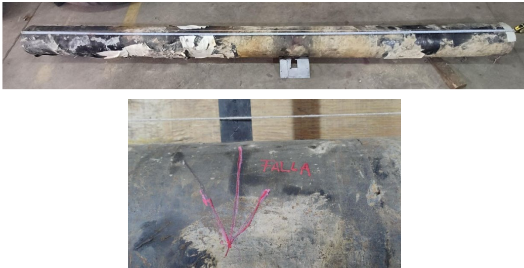
Fig. 3. Tramo que contenía la falla – Arriba: Medición de la deflexión en el tramo fisurado. Abajo: Indicación de fuga en parte convexa.
