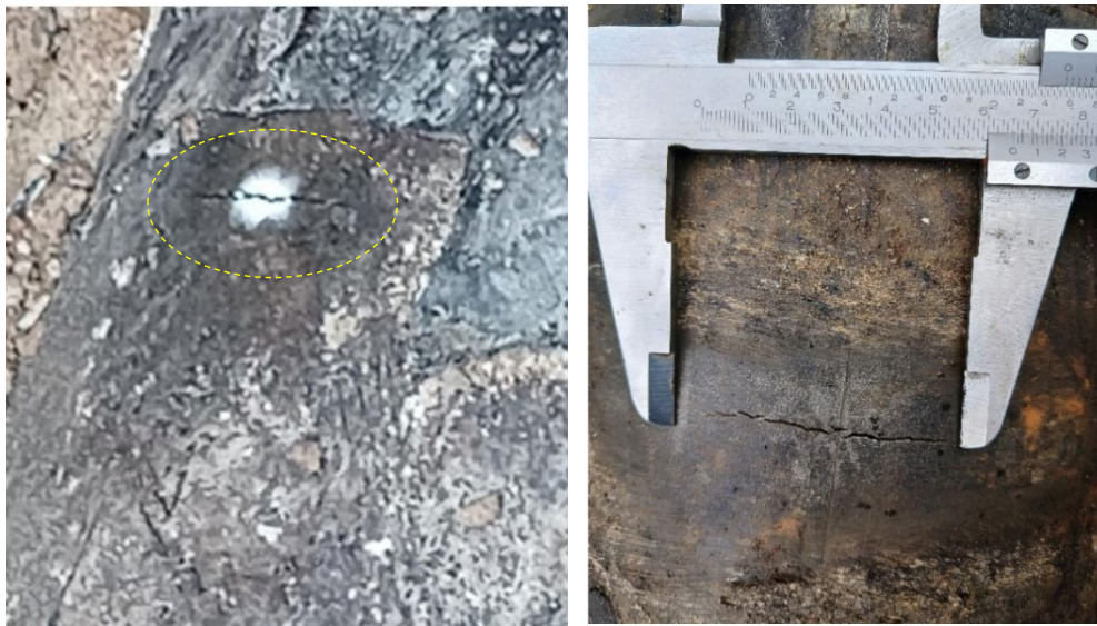
Fig. 2. Fuga por fisura circunferencial. (a) primera detección, (b) meses después, al retirar la reparación provisoria.
