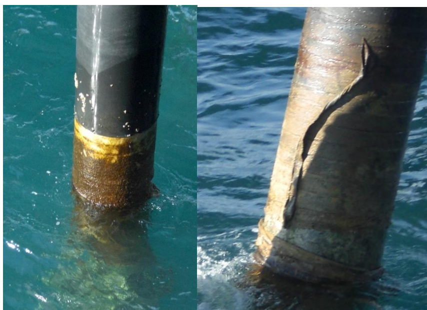
Fig. N° 8 – El resultado de las cintas aplicadas en espiral mucho dependen de las capas externas de protección mecánica, las cuales tienden a desprenderse y caerse, dejando las cintas de petrolato sin protección.
