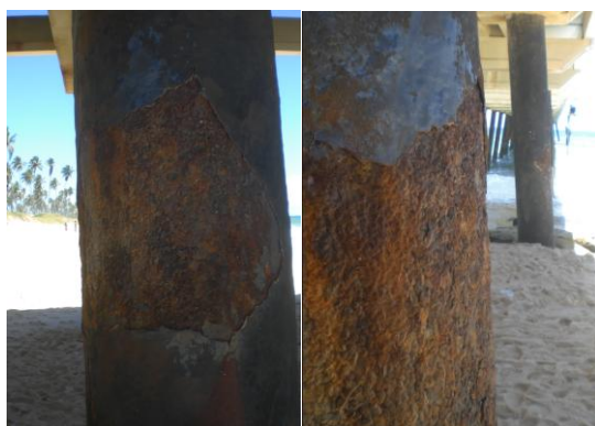
Fig. N° 6 – La aplicación de epoxis de gran espesor sin eliminar los cloruros y sin perfiles de anclaje adecuados conduce a un fracaso inevitable
