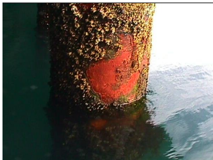
Fig. N° 2 – Revestimiento fallando en la zona de salpicadura – Corrosión rápida
