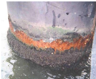
Fig. N° 1 – Revestimiento fallando en la zona de salpicadura
