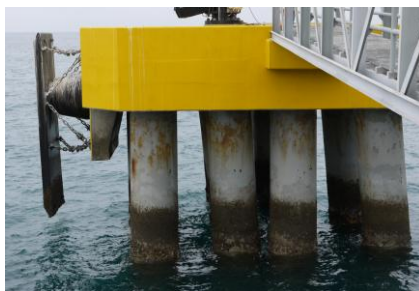
Fig. N° 4 – Los pilotes ubicados en delfines suelen estar inclinados y muy cerca los unos de los otros, lo que hace que el acceso para la limpieza y la aplicación sean complicadas
