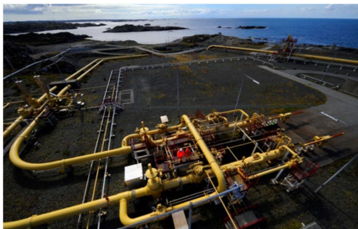
Figura 14: Una parte terrestre del gasoducto del cliente
