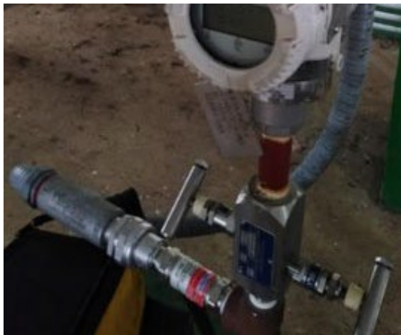
Figura 5: Transmisor de presión instalado en la tubería del cliente
