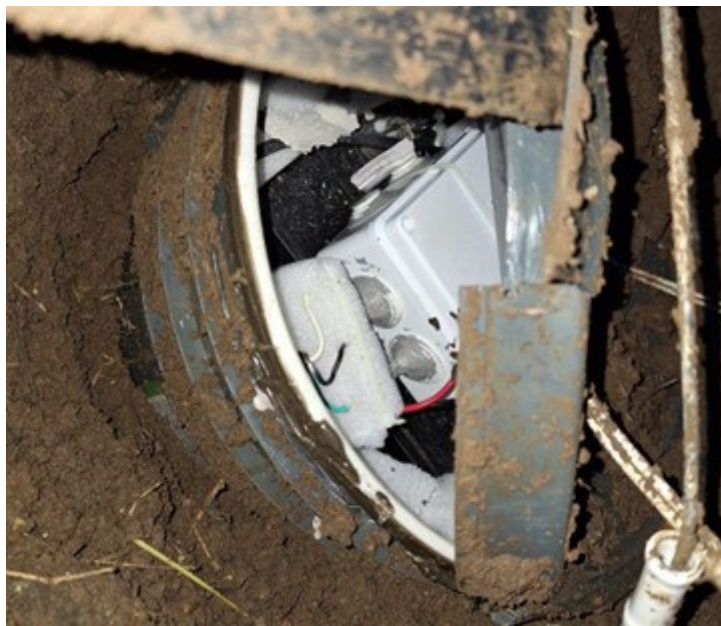
Figura 2: Punto de toma operado por batería
