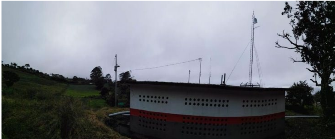
Figura 4: Enlaces de radio 4G instalados en la tubería del cliente
