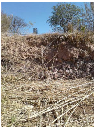
Figura 31. Obra de protección de margen desmoronada
