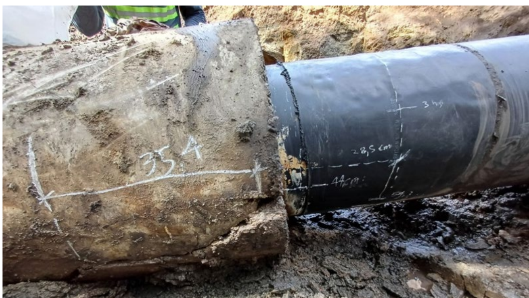
Figura 14. Recubrimiento de hormigón. Caso 2.
