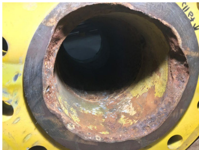
Fig. 3. Borda. Pitting sobre borde interno. Corrosión localizada en el asiento de la brida.
