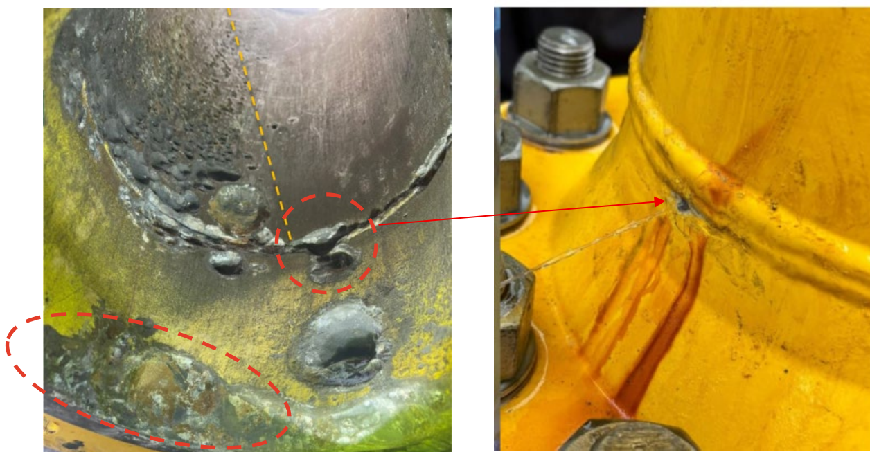
Fig. 1. defectos internos por corrosión en el asiento de la brida
