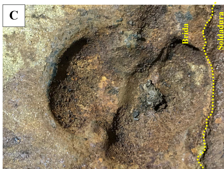
Fig. 6. Defecto pasante que ocasionó la fuga. Corrosión interna localizada.
