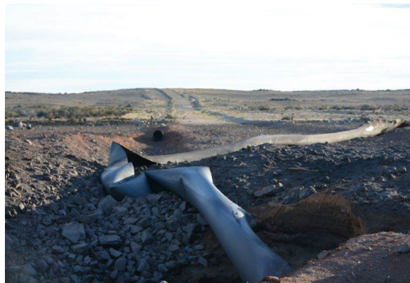
Fig. 2. Falla en soldadura longitudinal DSAW; combinación de defectos planos interno y externo de fabricación.
