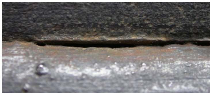
Fig. 22: Superficie interna defecto B. Zona de apertura criogénica P31. Se observan defectos en el talón de soldadura.
