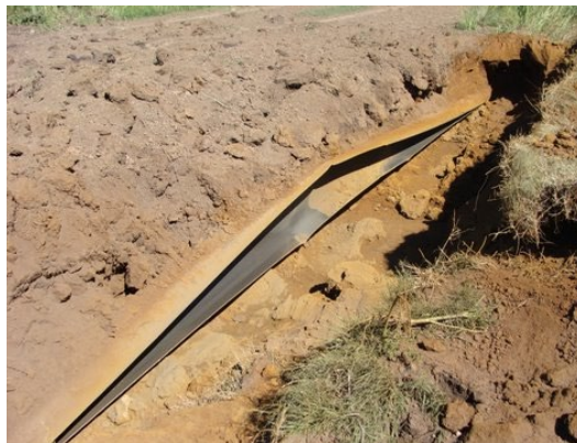
Fig. 1. Falla en soldadura longitudinal ERW; combinación de baja tenacidad/defectos planos en soldadura y SCC.
